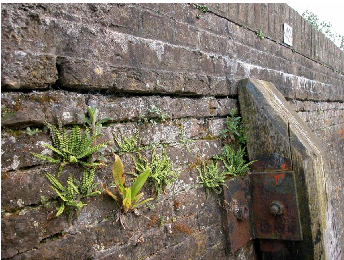
Kinderdijk : kade met oud metselwerk in handvormsteen met latere herstelling in machinale baksteen. Op de grens van de herstelling scheurt de muur. Dé plek voor de Steenbreekvaren.
