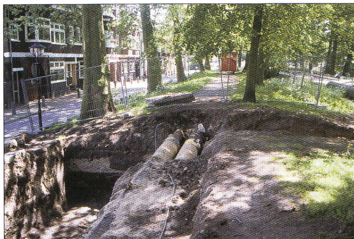
Graafwerk ten behoeve van kabels en leidingen verstoort telkens opnieuw het bodemmilieu in de directe omgeving van de bomen die beeldbepalend zijn voor het Singelpark. Zelfs de stadsverwarming ligt in de wortelzone van bomen. De status Rijksmonument houdt de kabelleggers niet tegen.
